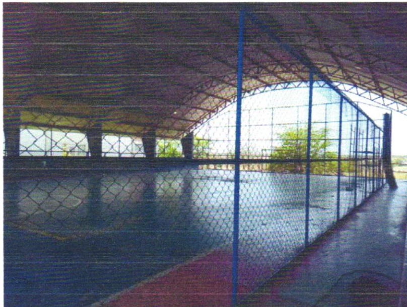
Foto 05 - ALAMBRADO PARA QUADRA POLIESPORTIVA, ESTRUTURADO POR TUBOS DE ACO GALVANIZADO, (MONTANTES COM DIAMETRO 2", TRAVESSAS E ESCORAS COM DIÂMETRO 1 ¼ ), COM TELA DE ARAME GALVANIZADO, FIO 10 BWG E MALHA QUADRADA 5X5CM (EXCETO MURETA). AF_03/2021
